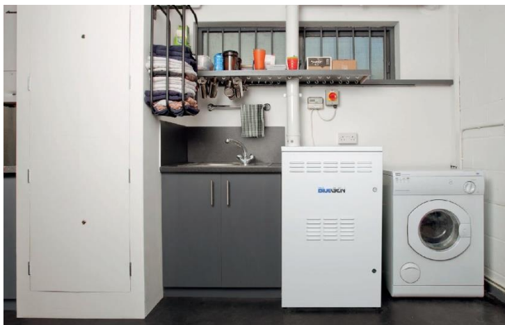
Figura 2. Sistema CHP instalado en una vivienda. Fuente (Solid Power, s.f)
