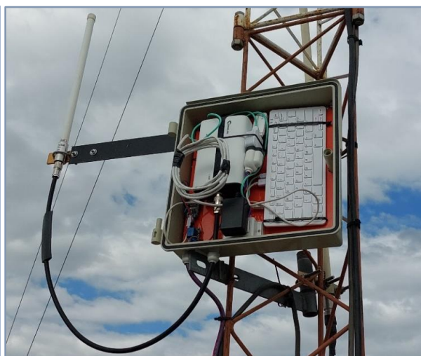
Figura 3. Vista del gabinete exterior con la antena, instalado en un edificio céntrico.
