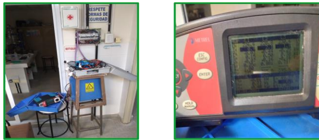
Fig. 1. Funcionamiento del analizador de redes Metrel.
